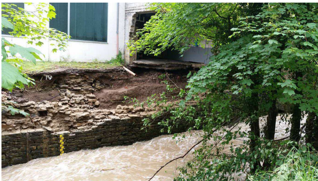
Station d'observateur détruite à Grundhof
