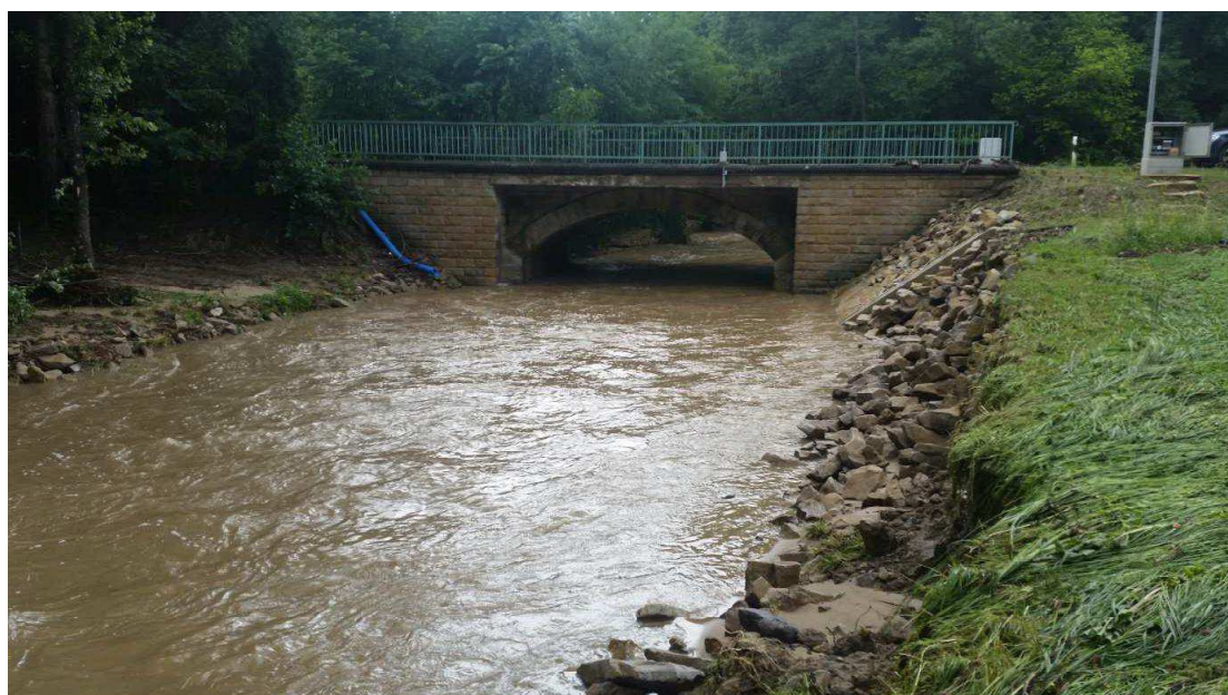
Dégâts aux berges après la crue subite sur la station limnimétrique de Müllerthal
