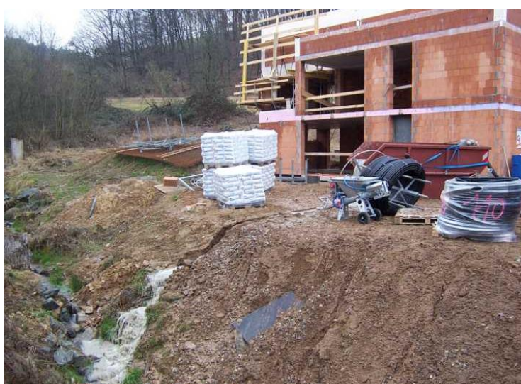
Figure 6-1: Pollution des eaux de surface par débordement de la benne de récupération des boues de forages.
