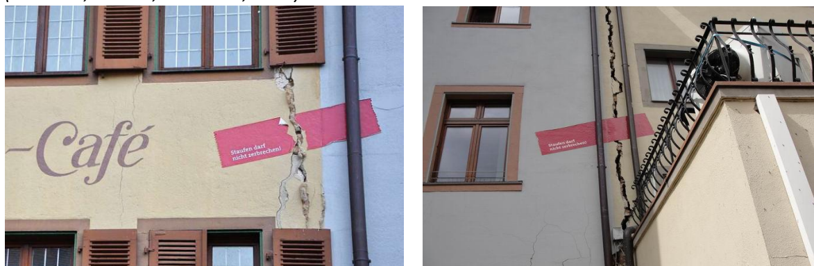
Figure 6-3: La transformation de l'anhydrite en gypse a entraîné une élévation de la surface et a causé des dommages sur des bâtiments à Staufen (BZ-Redaktion, 2019) (Risse Staufen, 2011).
