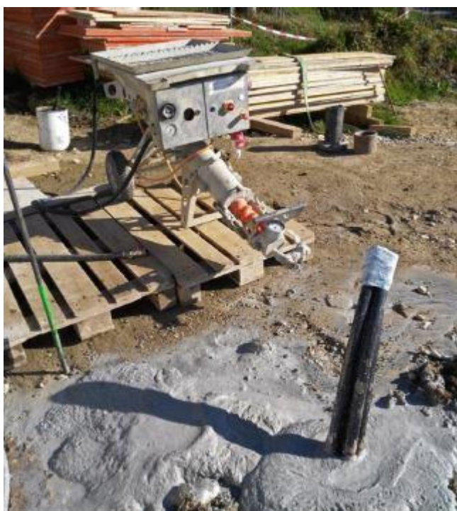
Figure 5-5: Cimentation complète du forage, le ciment est visible depuis la surface (Ebert, 2018).
