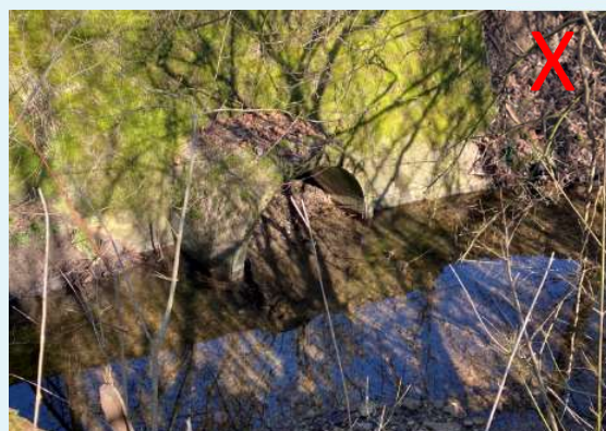
Exemple d'atterrissement formant un bouchon en sortie de tuyau.
