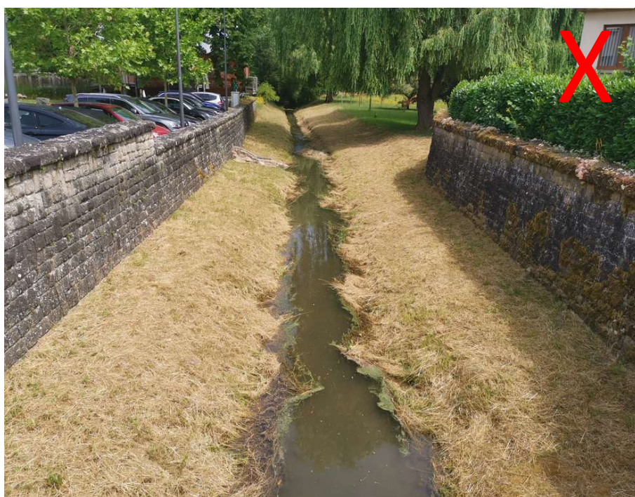
Exemple d'un fauchage excessif
