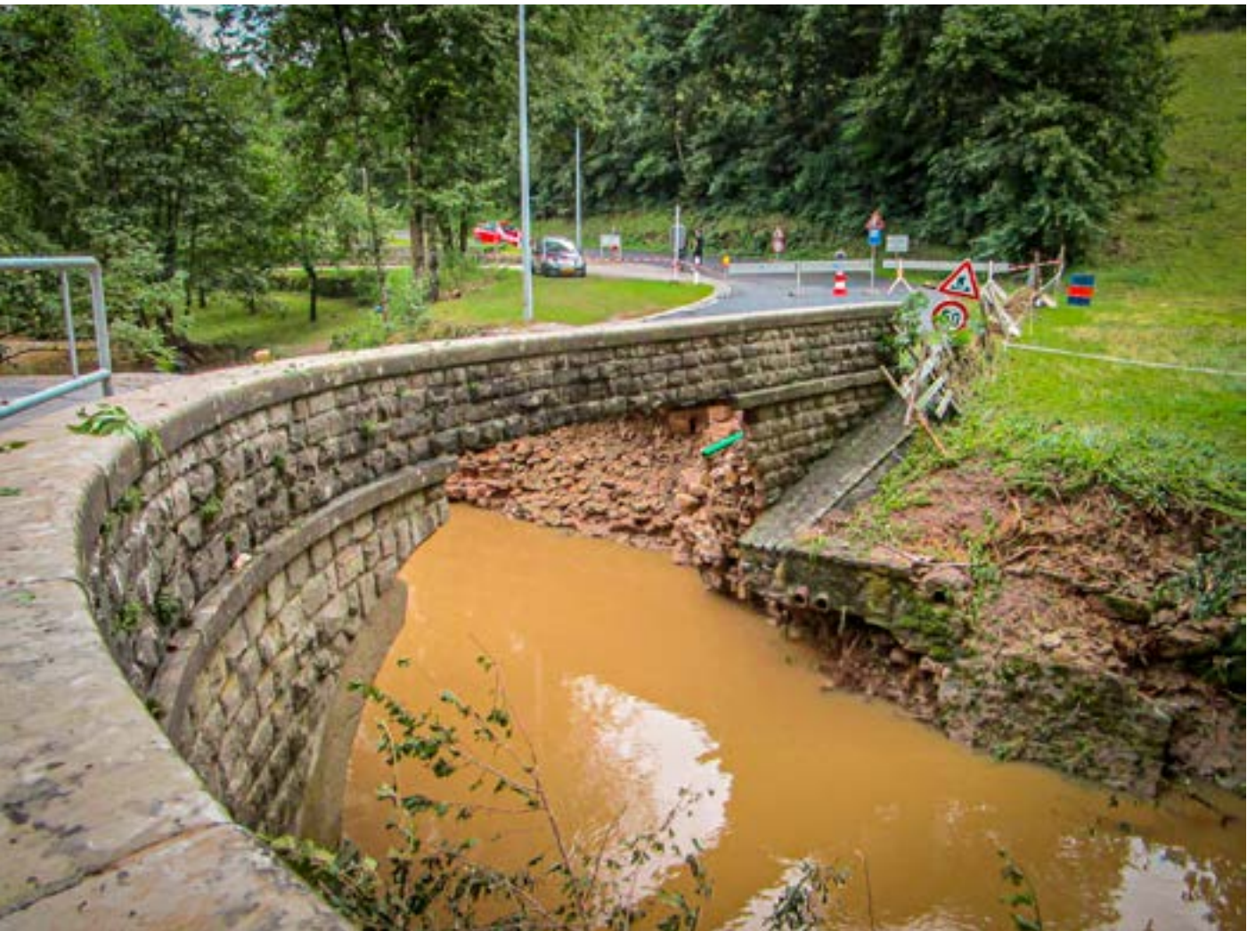
Schwere Schäden an einer Brücke über der Weißen Ernz bei Hessemillen nach einem Starkregenereignis im Jahr 2016.
