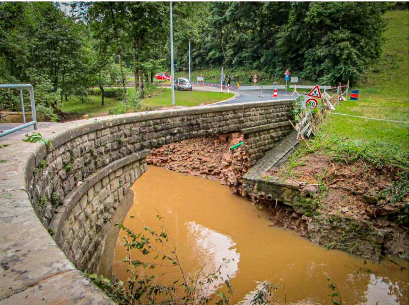
Schwere Schäden an einer Brücke über der Weißen Ernz bei Hessemillen nach einem Starkregenereignis im Jahr 2016.
