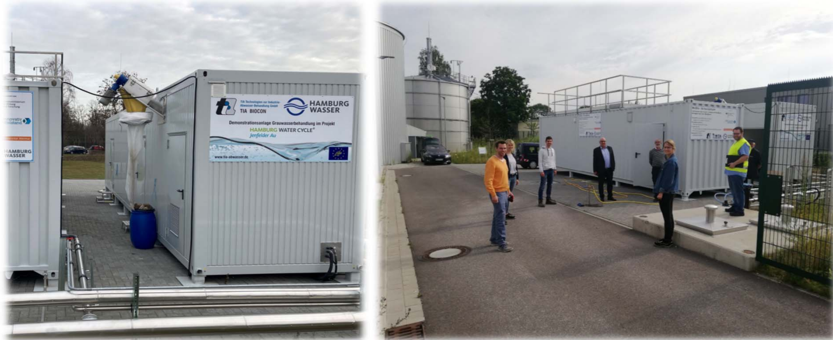
Inbetriebnahme einer Versuchsanlage zur Grauwasseraufbereitung im August 2020
