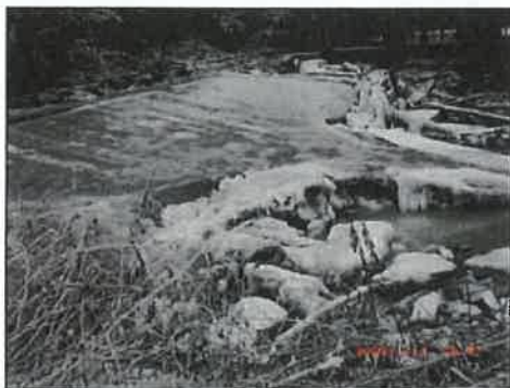
Vue sur l'aval du barrage (partie basse dégradée)
