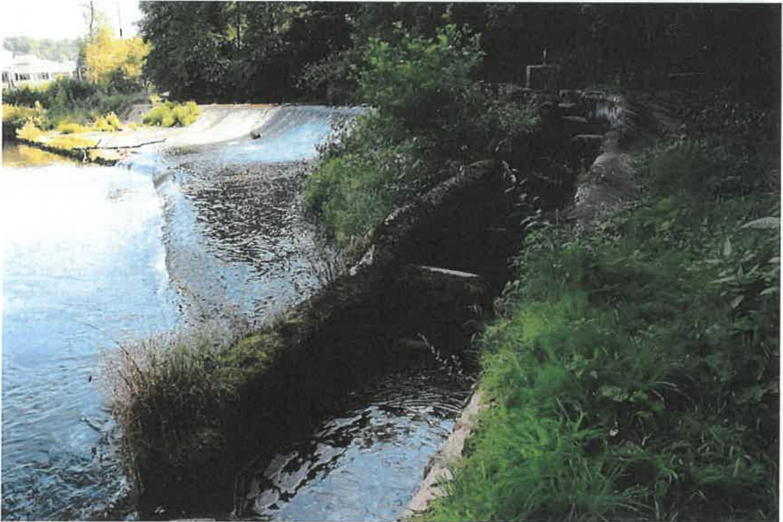
Passé à bacs existante avec vanne de régulation
