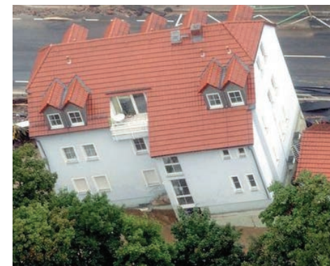
Figure 19 Effondrement d'un bâtiment
